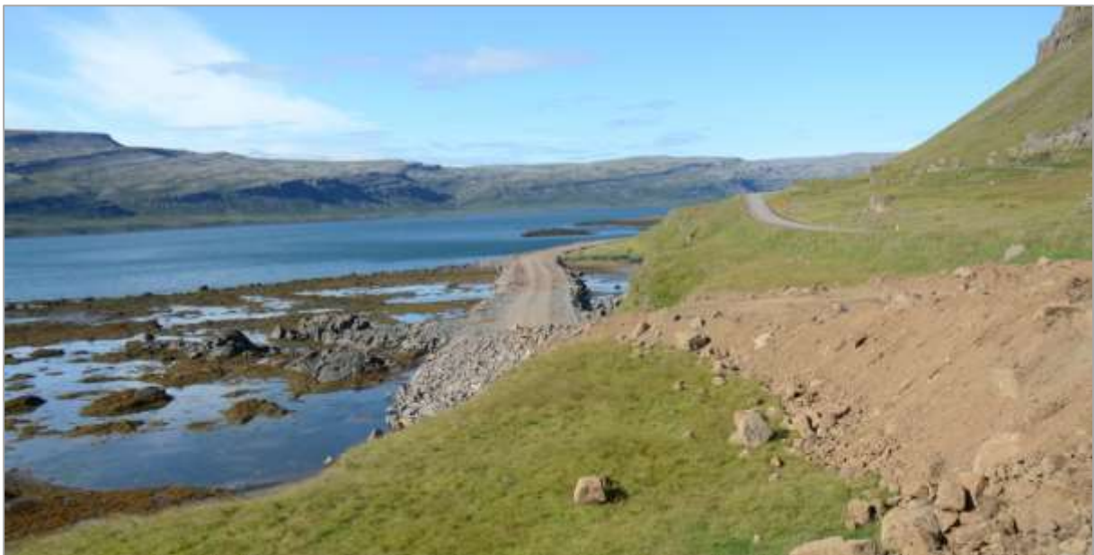
Mynd 4.1.2. Framkvæmdir við Vestfjarðaveg á Litlani í Kjálkafirði (ljósmynd: G. Pétur Matthíasson, 2013).
